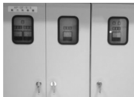
F社の空調制御盤
