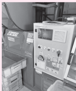
▲廃家電リサイクルプラントを構成する装置・システム①「銅アルミなどの高純度選別とナゲット加工ができる装置」
